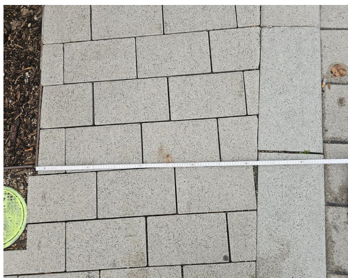
Rétrécissement du trottoir devant le 17 rue du Gal Gouraud, largeur env. 1.20 m – 10/2026
